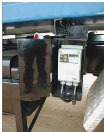
Combustible Gas detector & Alarm (Audio & Visual).
